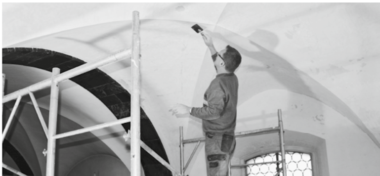
Auch wenn renoviert wird: Die Pfarr- und Wallfahrtskirche Sachseln bleibt während der gesamten Bauzeit benutzbar. (Bild: Donato Fisch)
